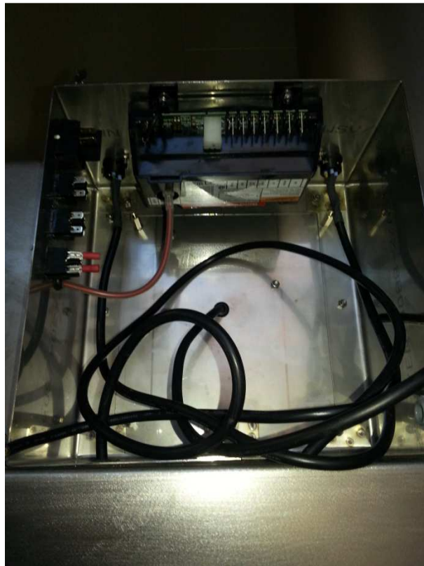
Abbildung 6: Schaltkasten in Vorbereitung mit Automatik Zündeinheit S8610U
